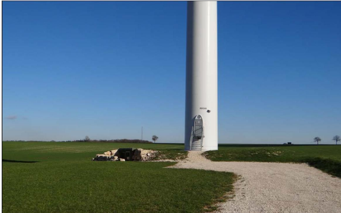
Photo 4 - Transformateur semi enterré au pied de l'éolienne- exemple d'un parc existant (MAÏA Eolis)
